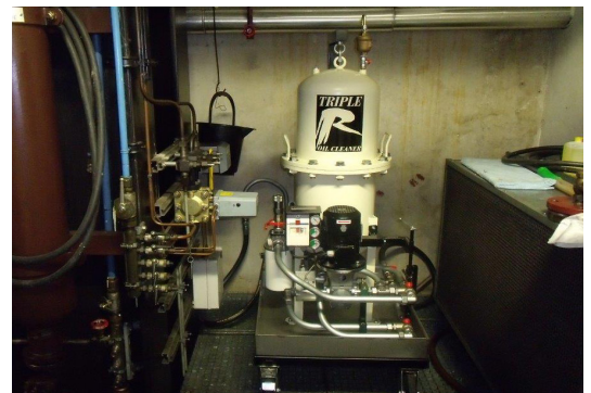
Heute: Triple R OSCA installiert, ständige Ölreinigung
